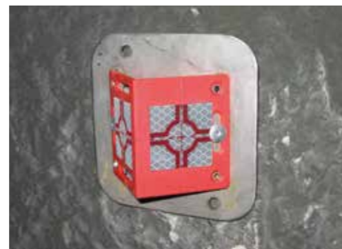
Túnel Coen Ámsterdam
